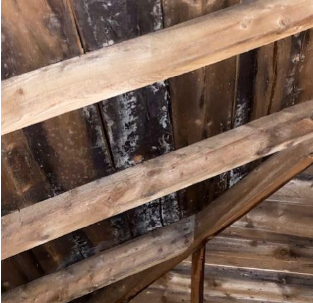
Moisissure dans l'entre-toit
