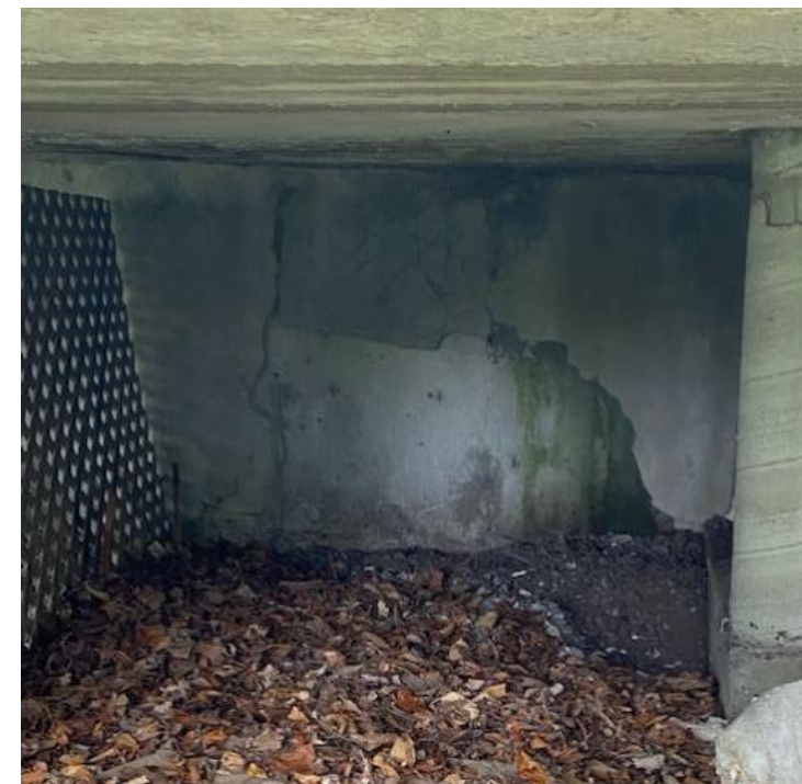
Efflorescence mur de fondation
