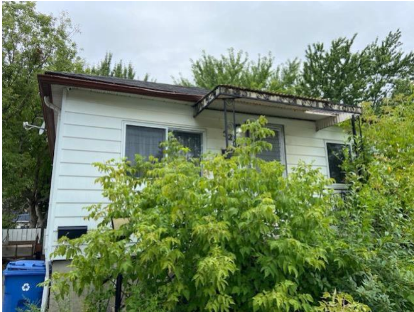
État du revêtement de vinyle
