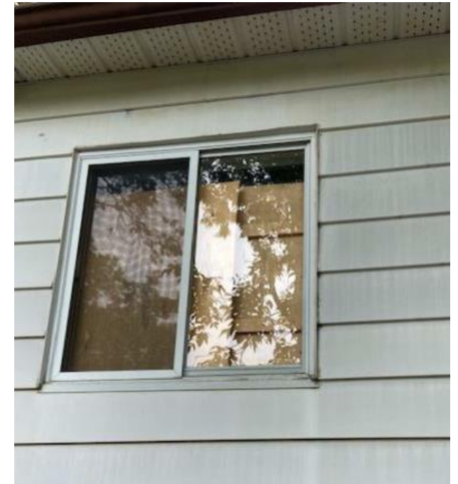
État d'une fenêtre
