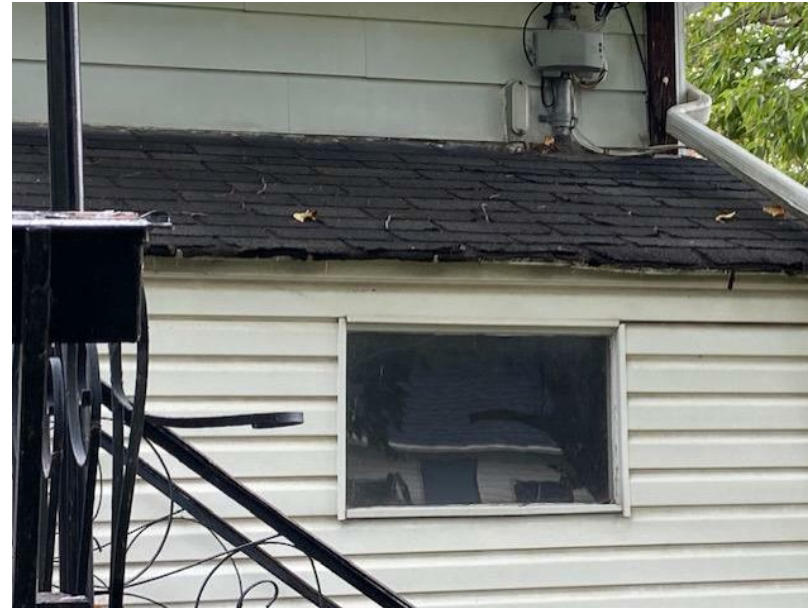
État des bardeaux d'asphalte
