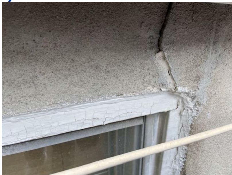
Fissure mur de fondation
