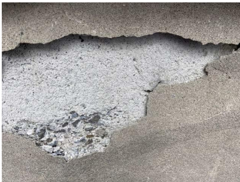
Éclatement mur de fondation
