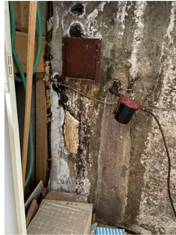
Efflorescence sur le mur de fondation
