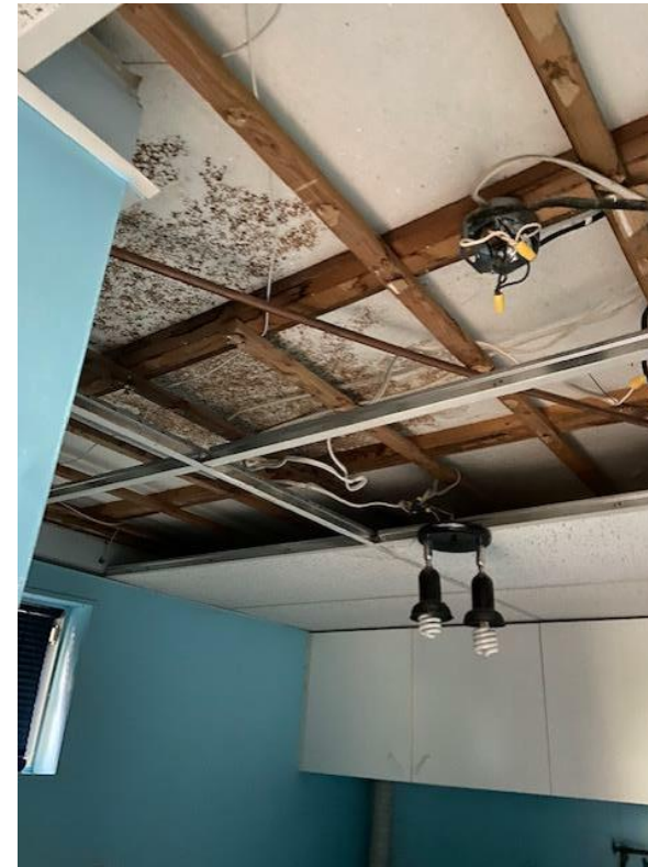
Présence de pourriture dans le plafond
