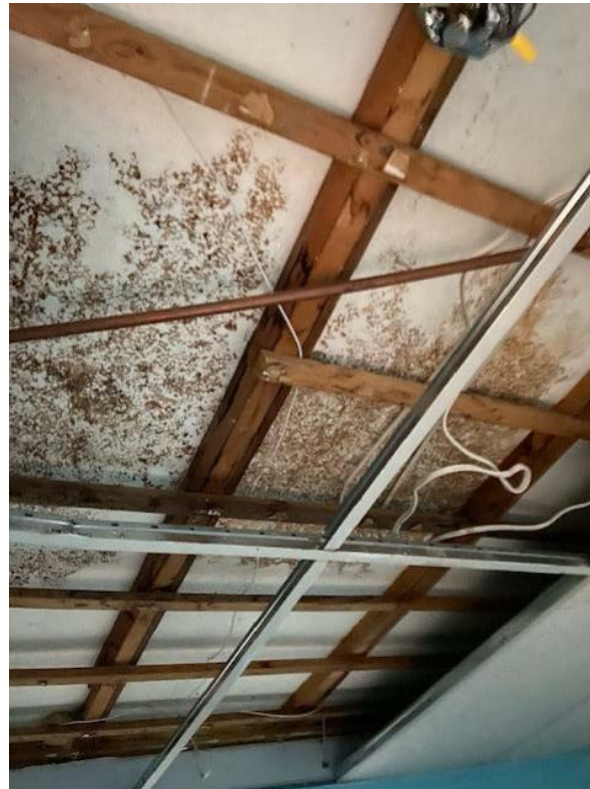
Présence de pourriture dans le plafond
