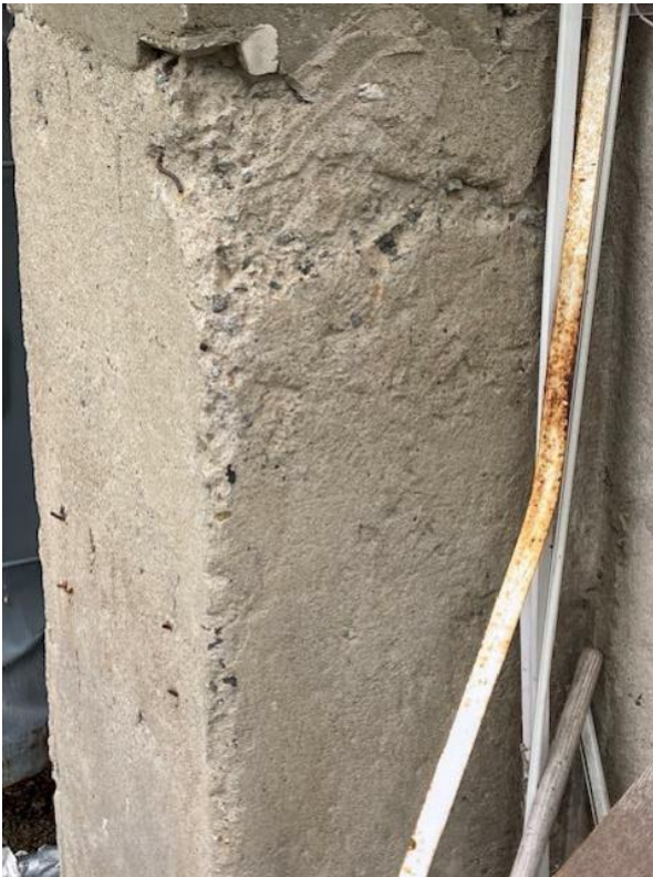
État mur de fondation
