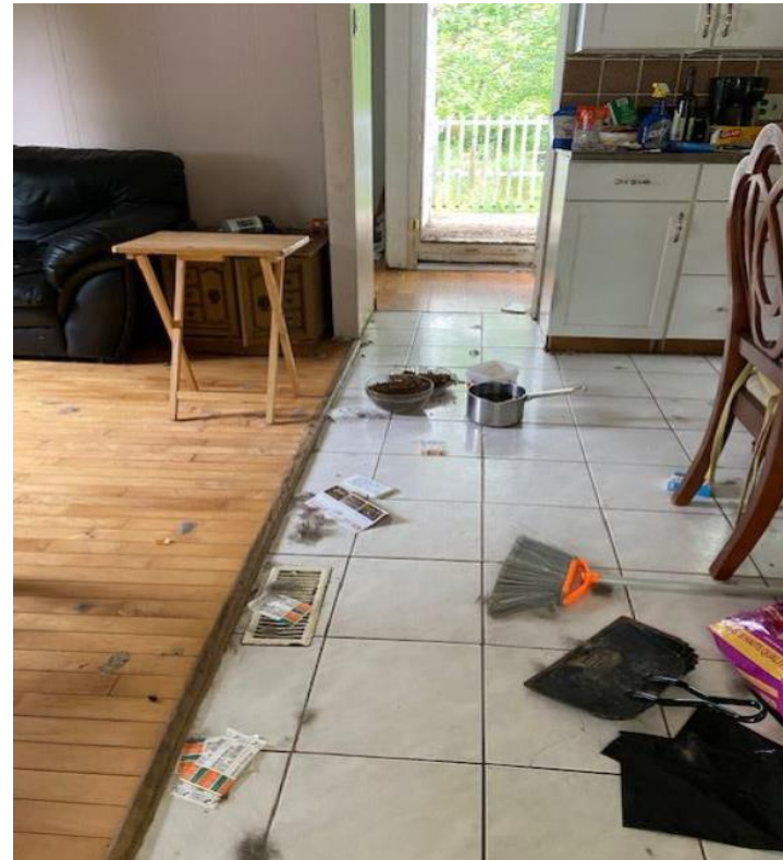
État intérieur - Insalubrité
