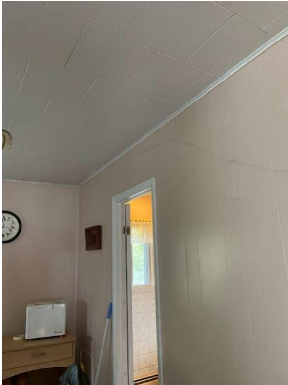
État intérieur - Insalubrité
