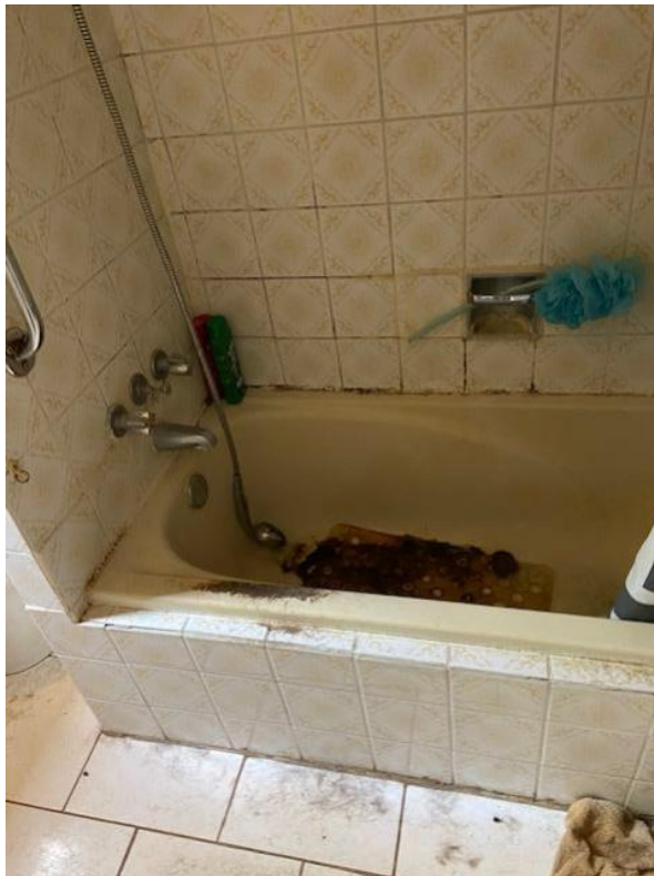
État intérieur - Insalubrité
