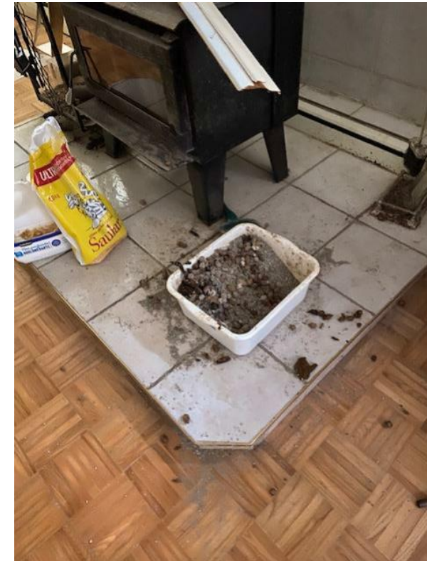
État intérieur - Insalubrité
