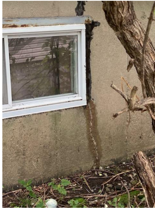
Fissure dans la fondation
