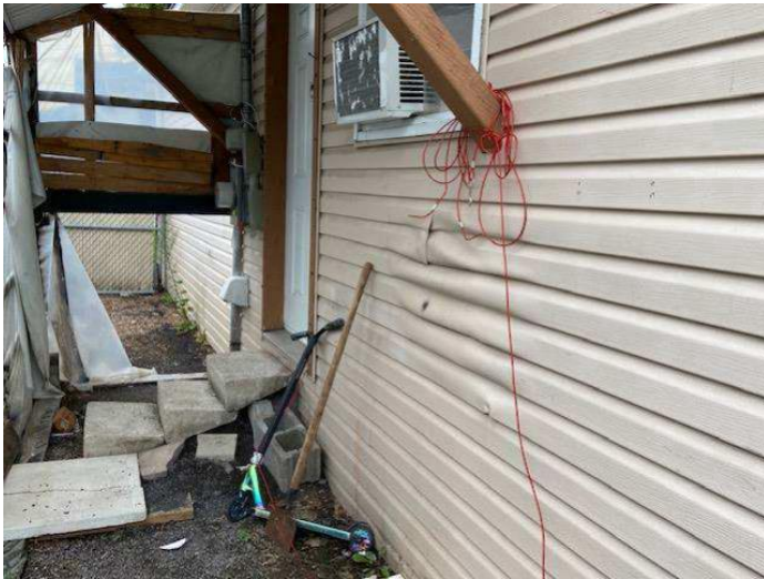
État revêtement de vinyle
