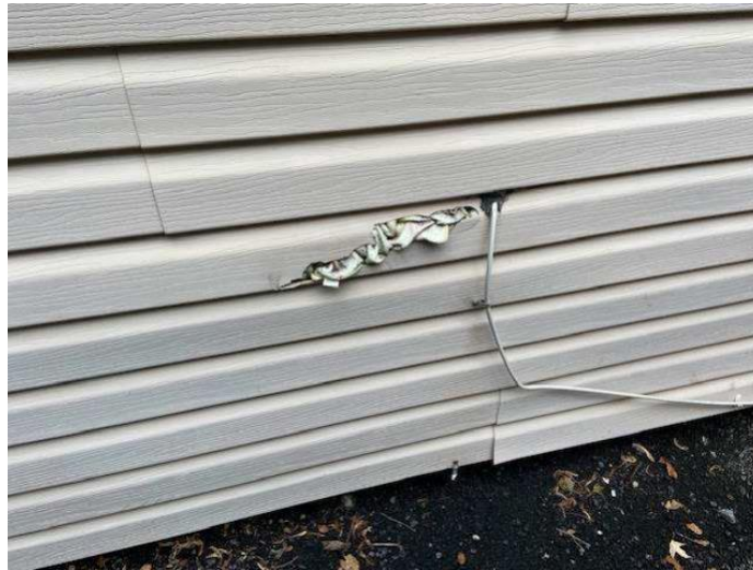
État revêtement de vinyle
