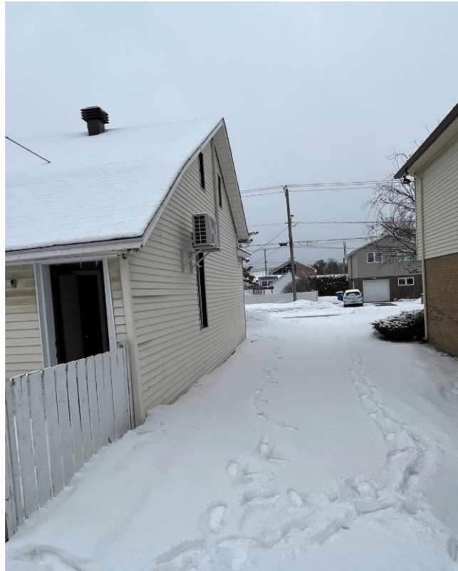
Déformation et faiblesse de la structure du toit
