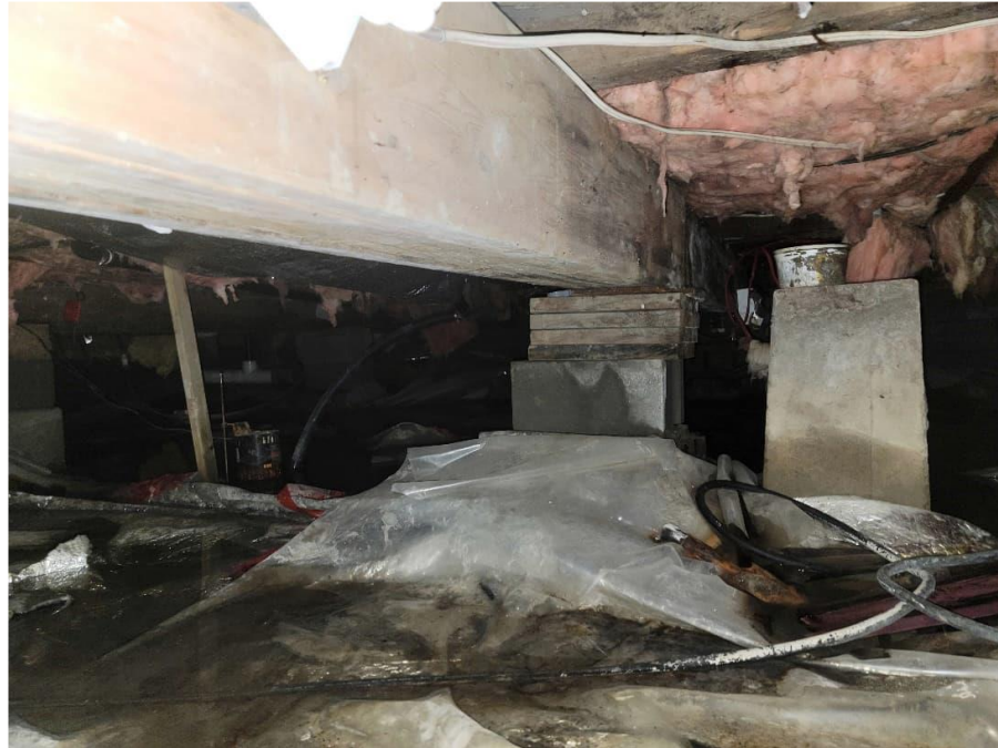
Infiltration d'eau au vide sanitaire
