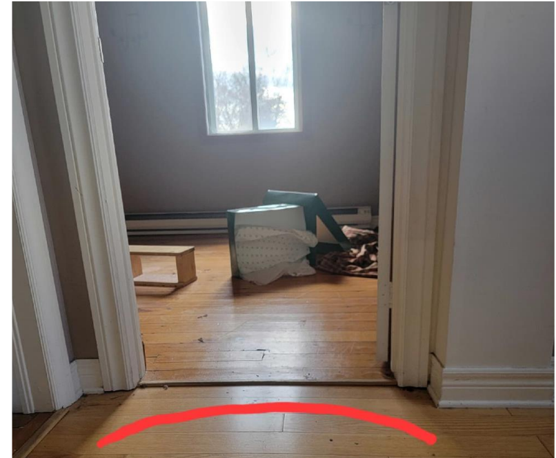
Structure du plancher de l'étage présente un bombement dû aux charges excessives
