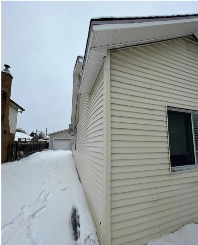
Ondulation du mur de revêtement en acier
