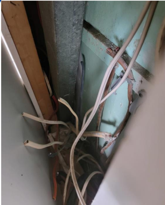
Panneau de distribution principal vandalisé
