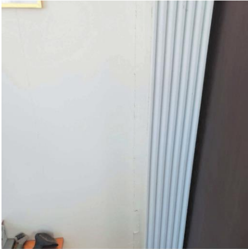
Fissures importantes sur les murs et plafonds
