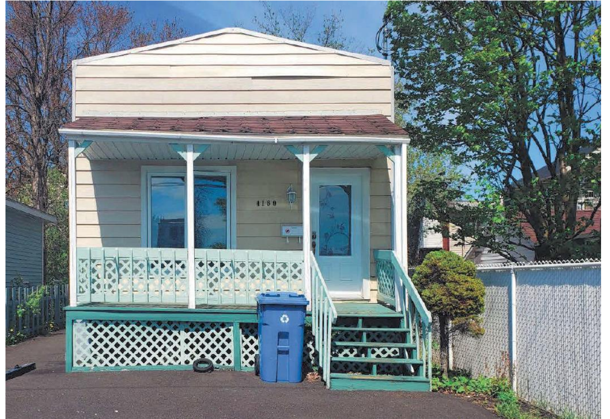
Déflexion de la structure du balcon avant
