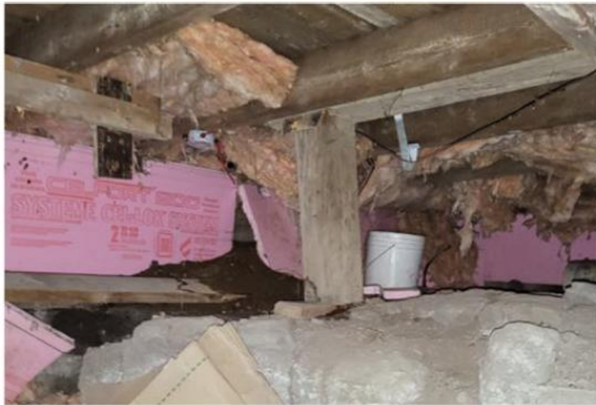
Photo 8 : Colonne du sous-sol croche et sans retenue latérale, nivelée avec un morceau de bois.
