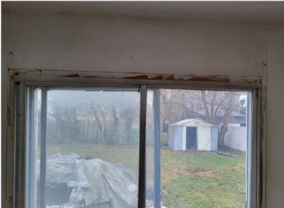
Photo 3 : Linteau affaissé vers le mur latéral droit.
