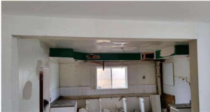
Photo 12 : Déformation et déplacement de la poutre entre la salle à manger et la cuisine
