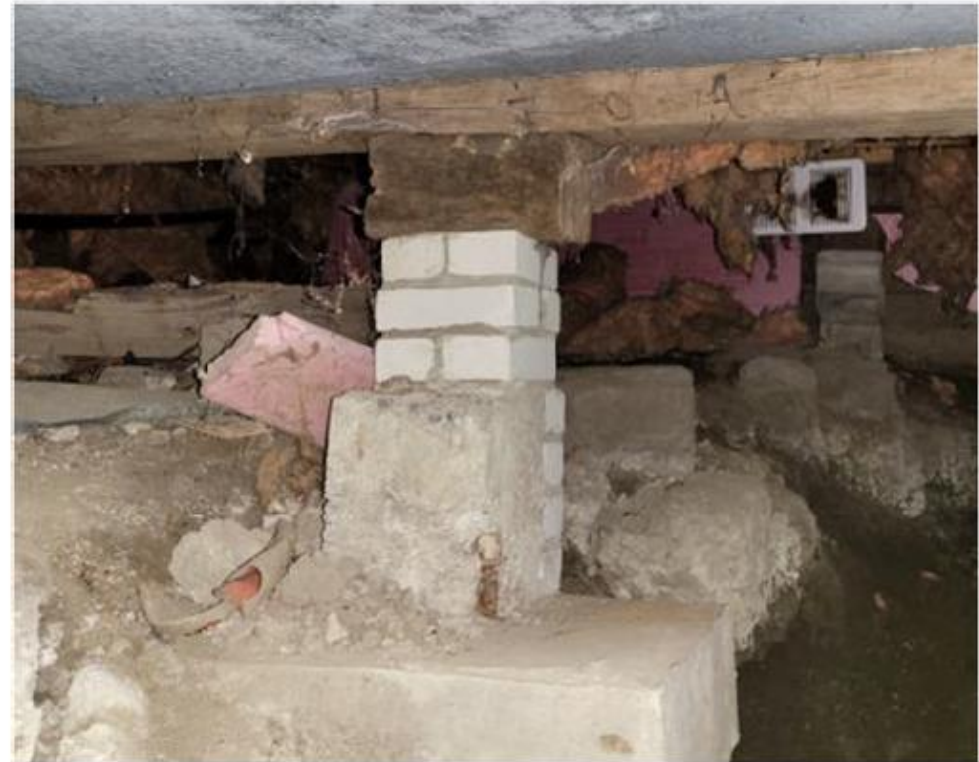
Photo 7 : Pilastre décentré de l'empattement.
