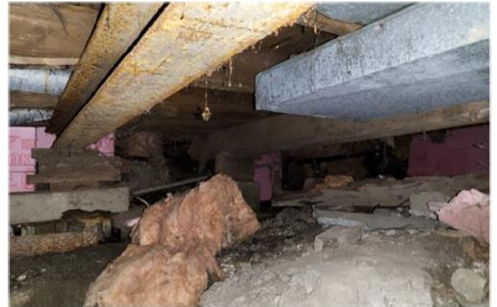
Photo 9 : Poutre d'acier corrodée et appui sur bois empilé
