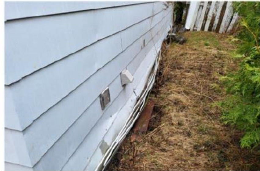
Photo 4 : Revêtement écrasé au sol suite à l'affaissement du mur latéral gauche.
