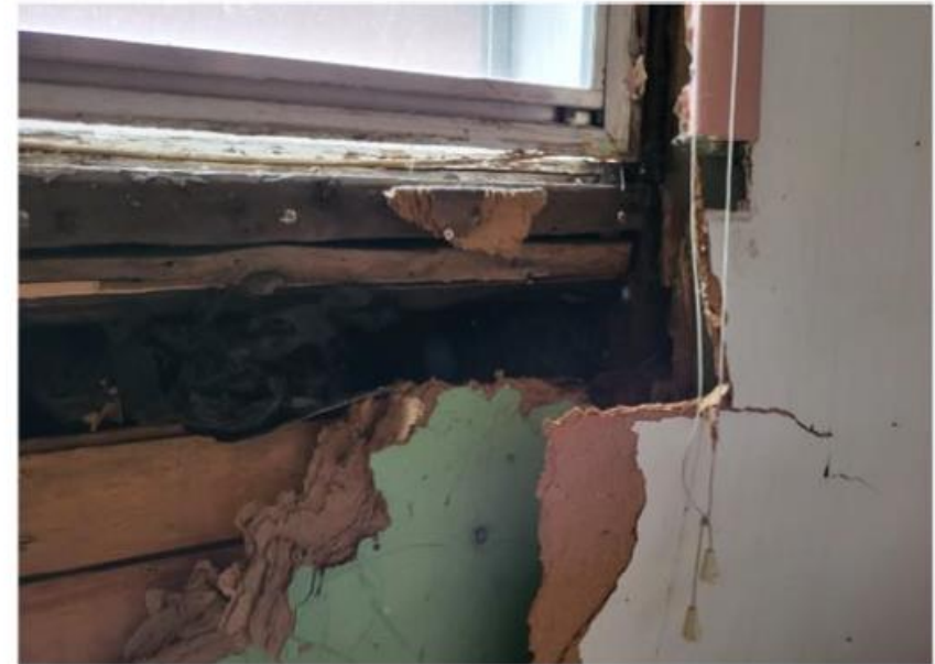
Photo 13 : Montants des murs extérieurs noircis et moisis.
