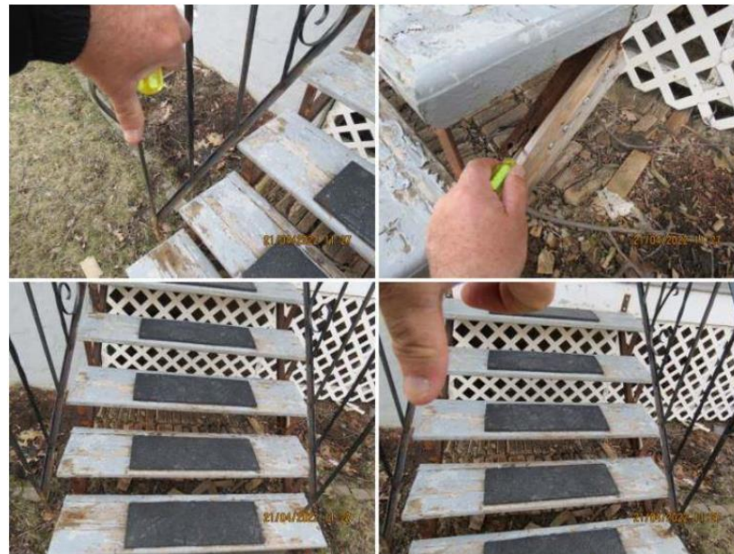
Traces de pourriture observées sur l'escalier métallique
