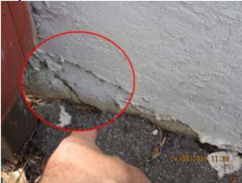
Présence de fissure dans la fondation
