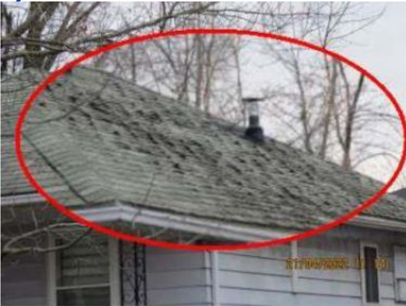
Signe de vieillissement avancé et bardeaux gondolés
