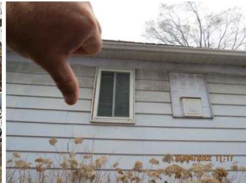
Fenêtres en fin de vie
