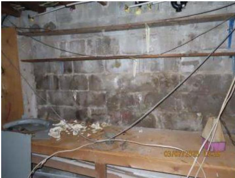
Traces d'efflorescence sur le mur de fondation
