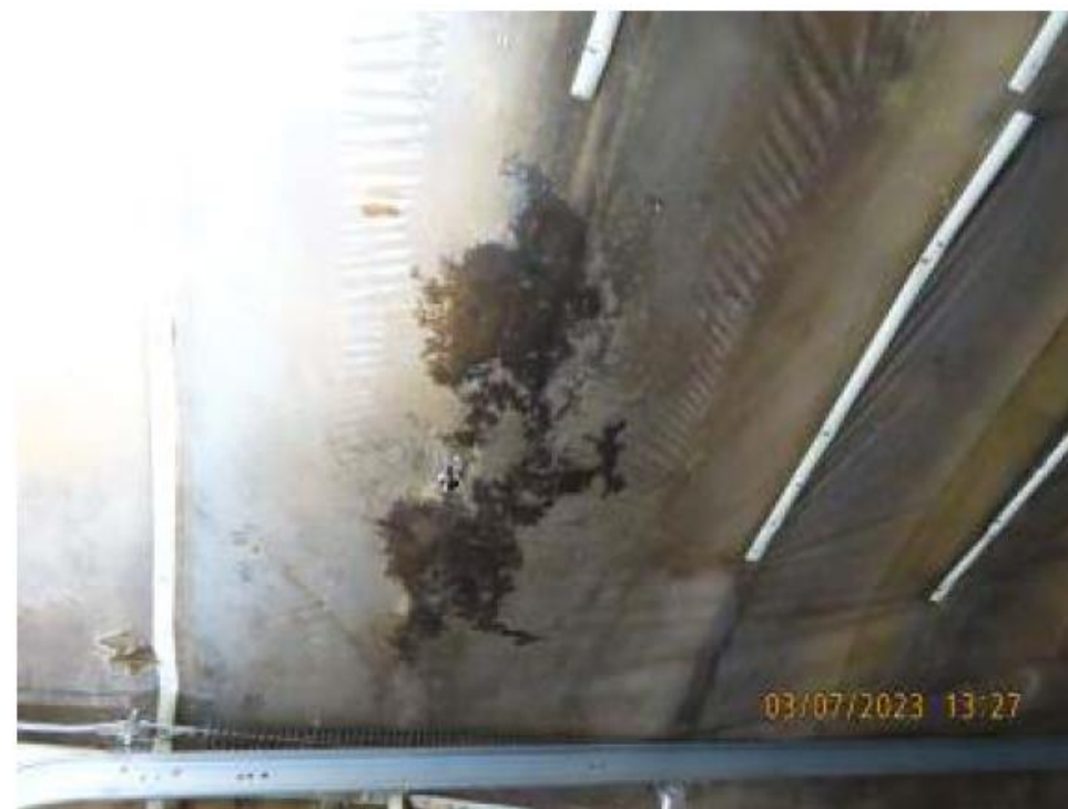
Domage d'eau sur le pare-vapeur
