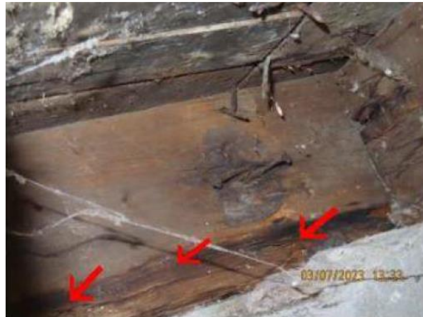
Présence de pourriture sur la solive de rive
