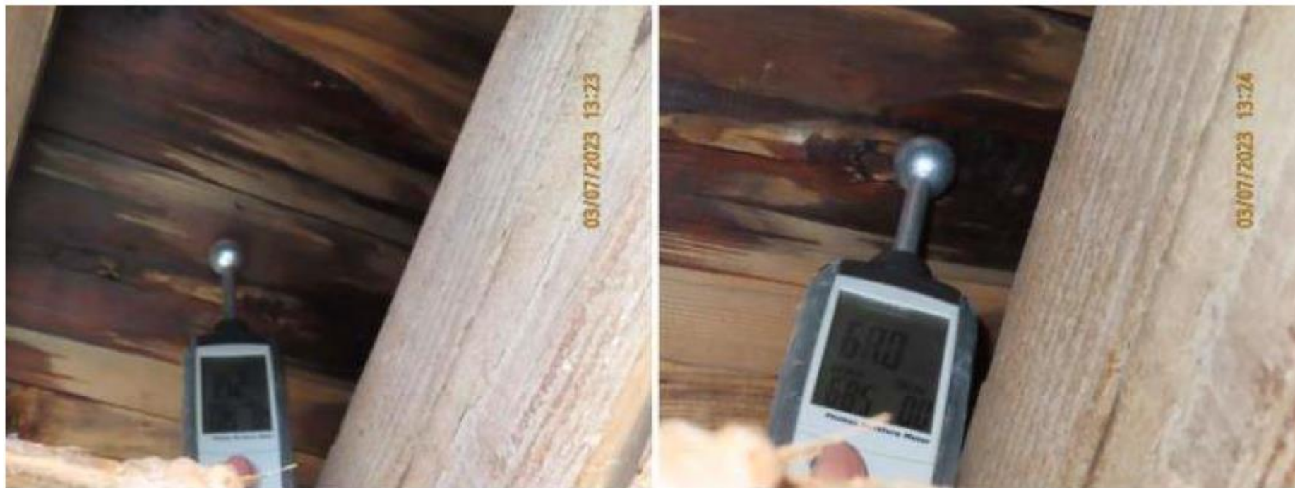
Traces d'eau sur le support de couverture
