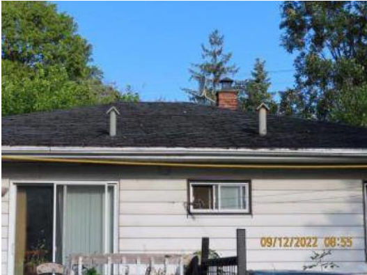
Toiture très gondolée
