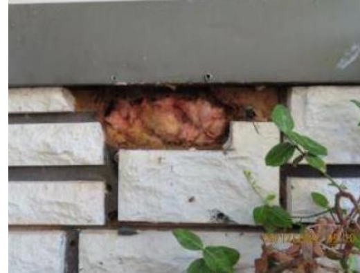
Maçonnerie décollant du mur extérieur
