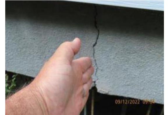
Exemple de fissure aux fondations
