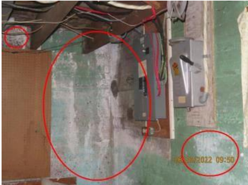
Présence d'efflorescence et de cernes d'eau sur le mur de fondation
