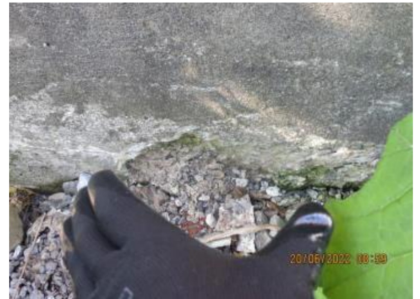
Effritement de la fondation
