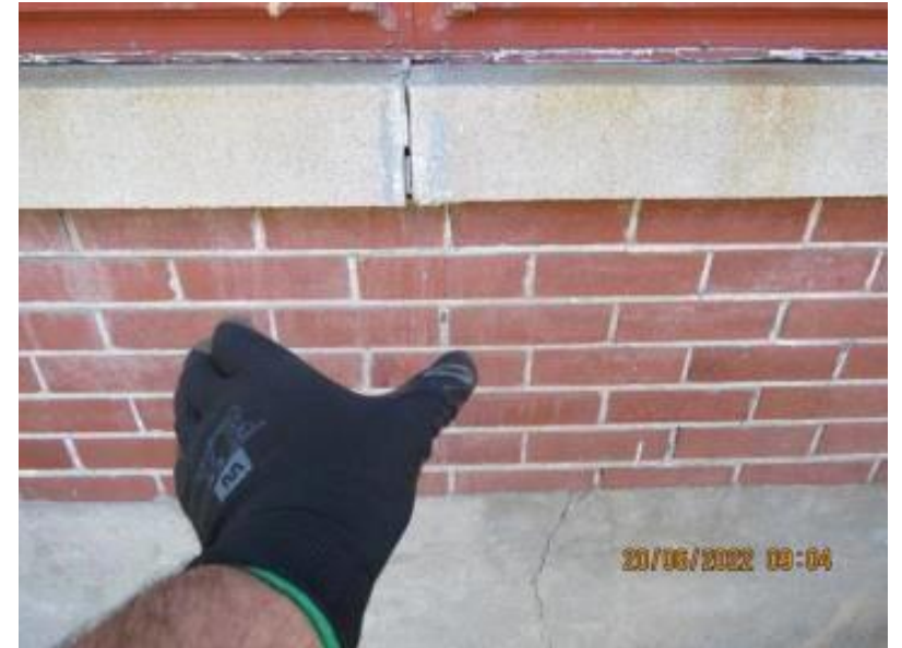
Présence d'efflorescence sur la brique
