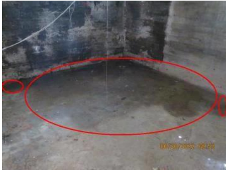
Présence de cernes d'eau
