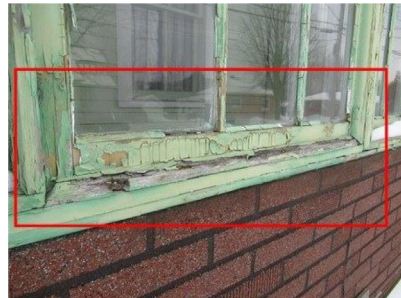
Dégradation des fenêtres
