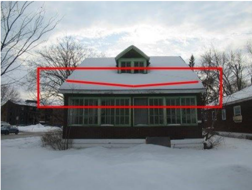
Déformation du toit
