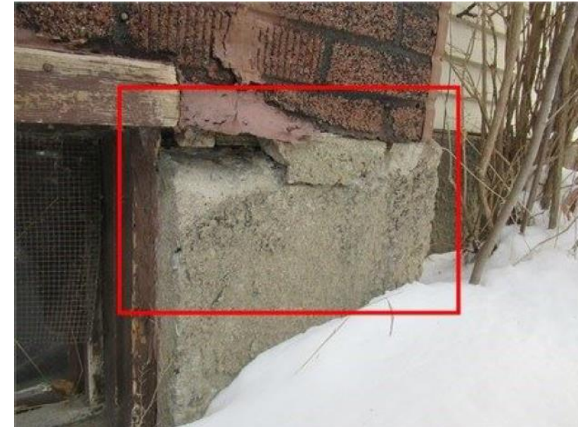
Effritement de la fondation
