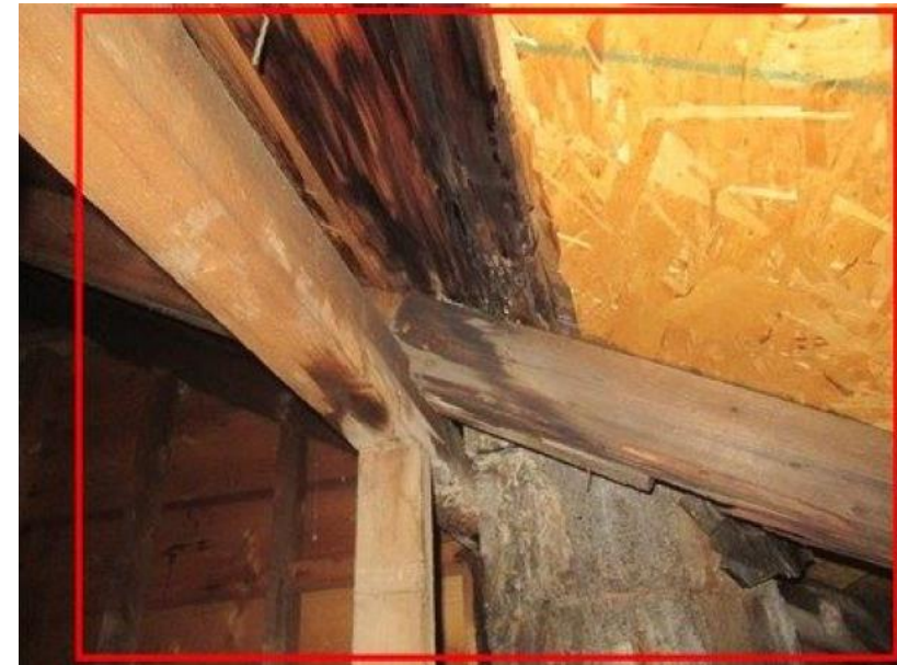
Présence d'infiltration d'eau dans l'entre-toit
