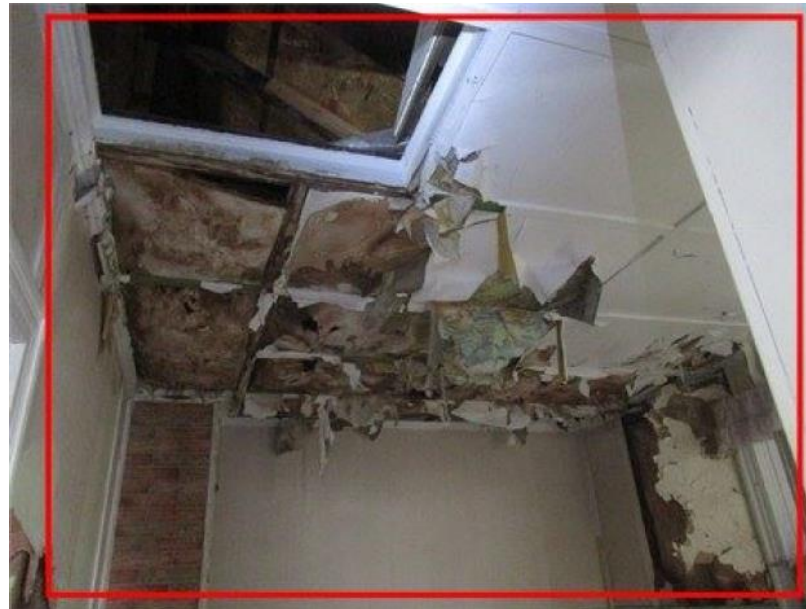
Domages causés par l'eau
