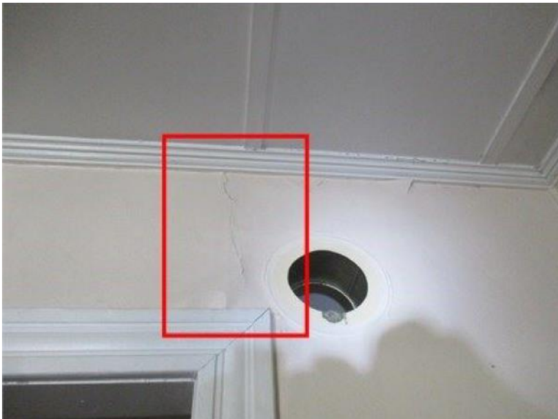
Présence de fissure
