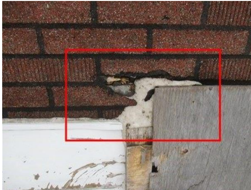
Dégradation des revêtements extérieurs
