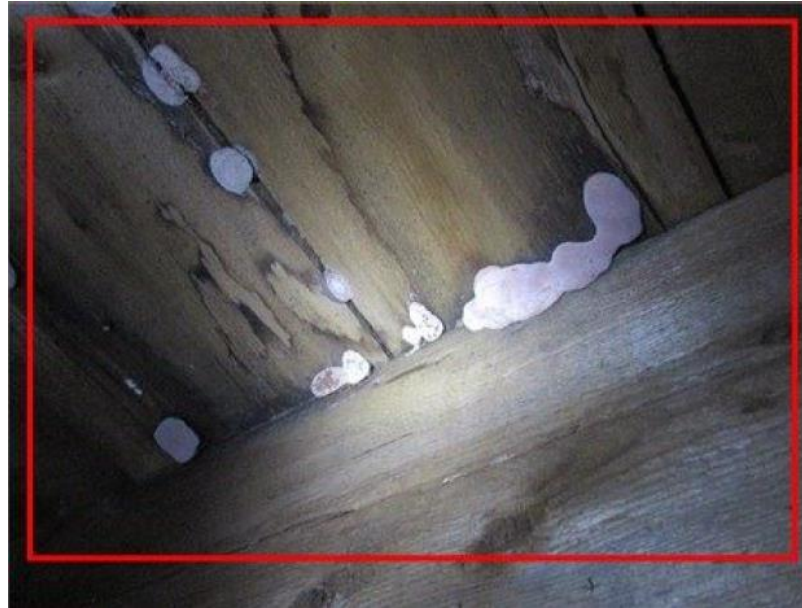
Présence de moisissure et de champignons
