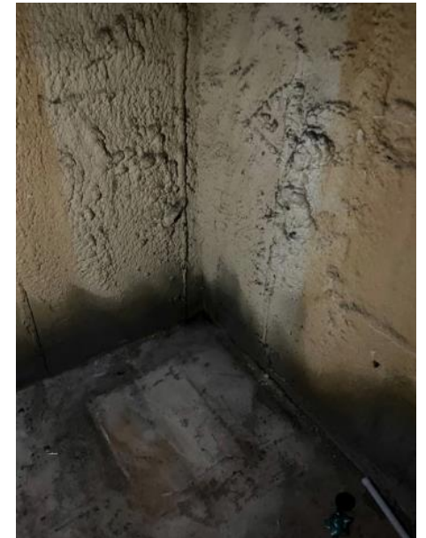
Infiltration d'eau au sous-sol
