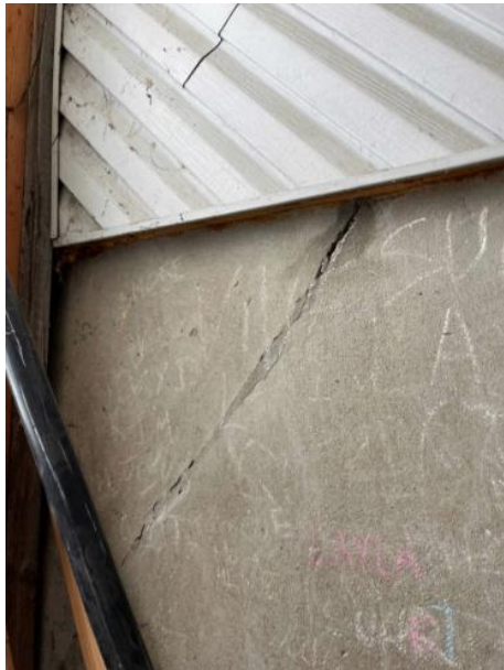
Fissure sur le mur de fondation
