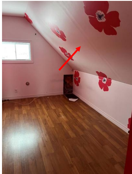
Fléchissement de la structure du toit
