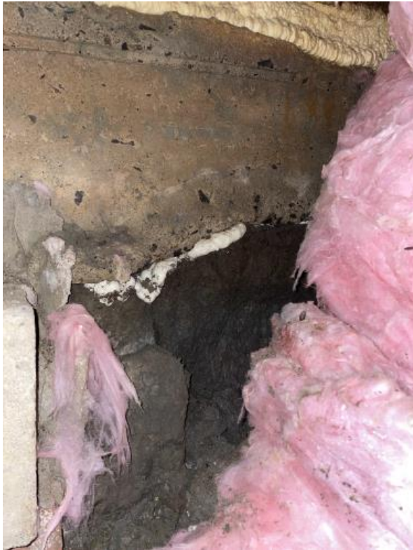
Absence de semelle sous le mur de fondation
