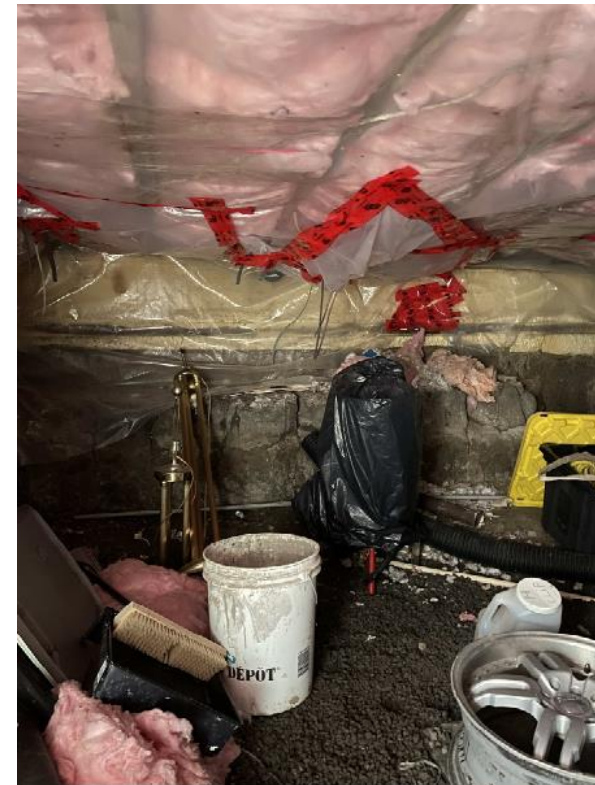
Fondation composée de grosses roches qui se détachent
