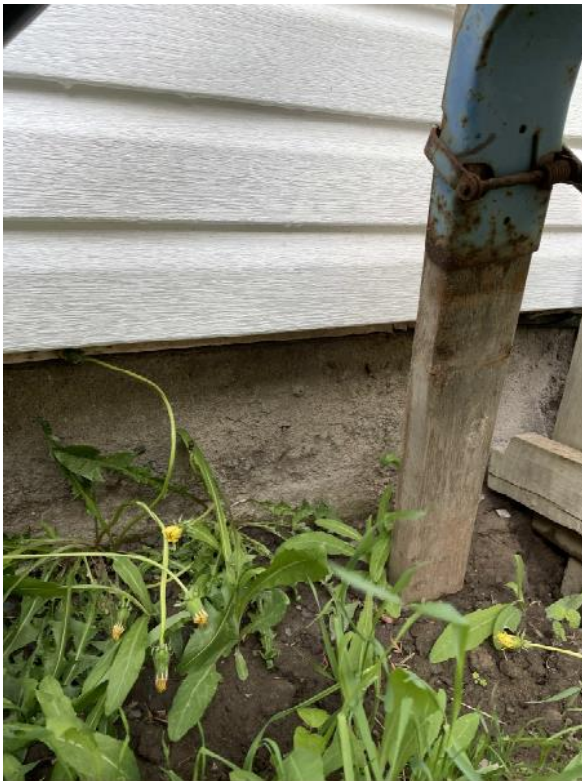
Effritement de la fondation
