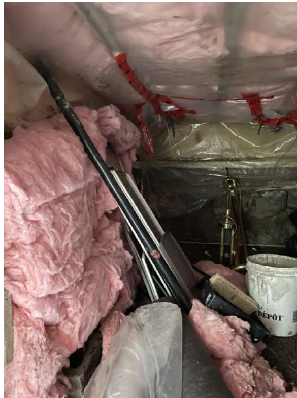
Effritement de la fondation (intérieur)
