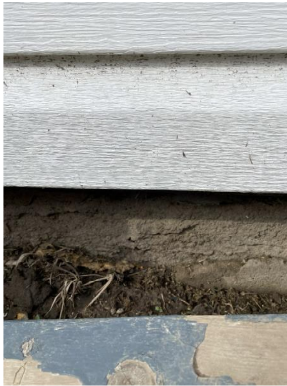
Effritement de la fondation
