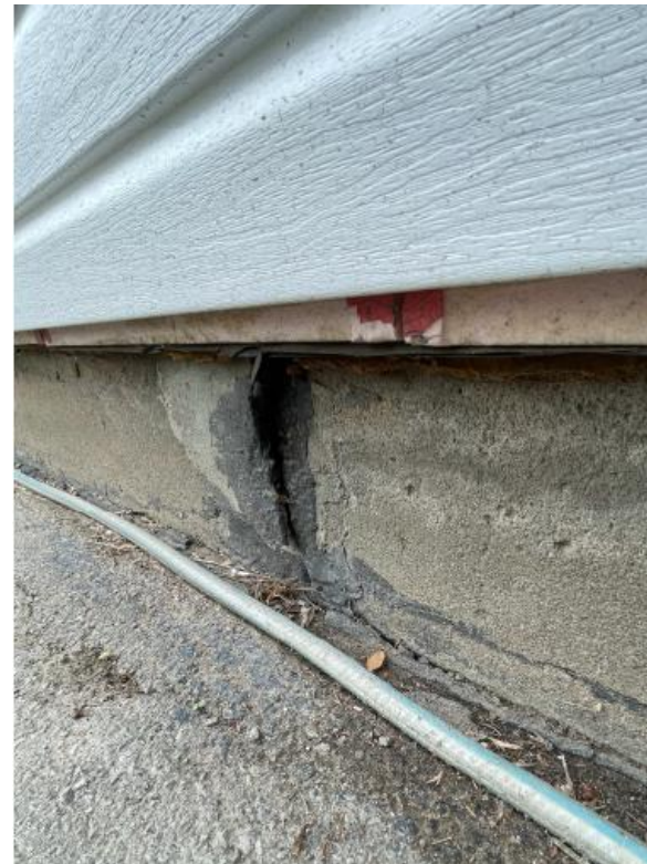
Fissure dans la fondation
