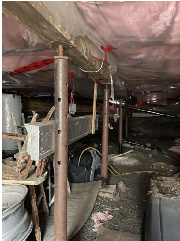
Base de béton sous semelle sous-dimensionné
