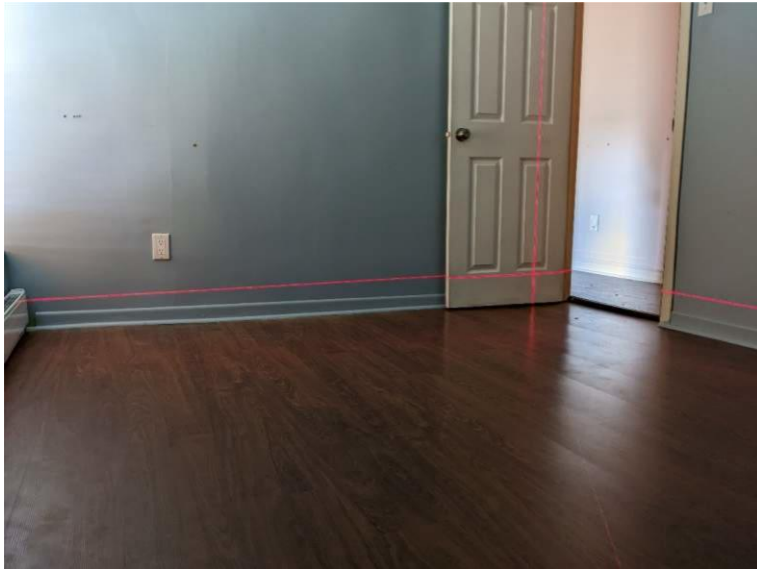
Flèche importante vers le mur porteur intérieur
