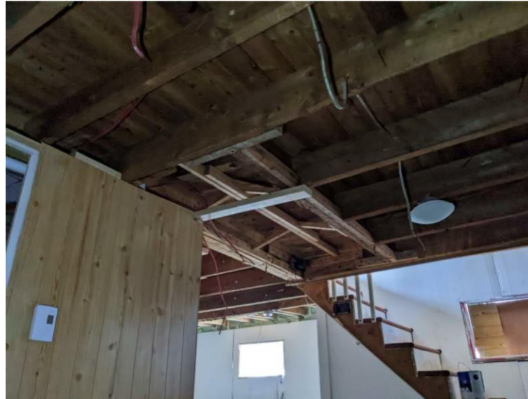
Obturation non-conforme de l'ouverture au plancher
