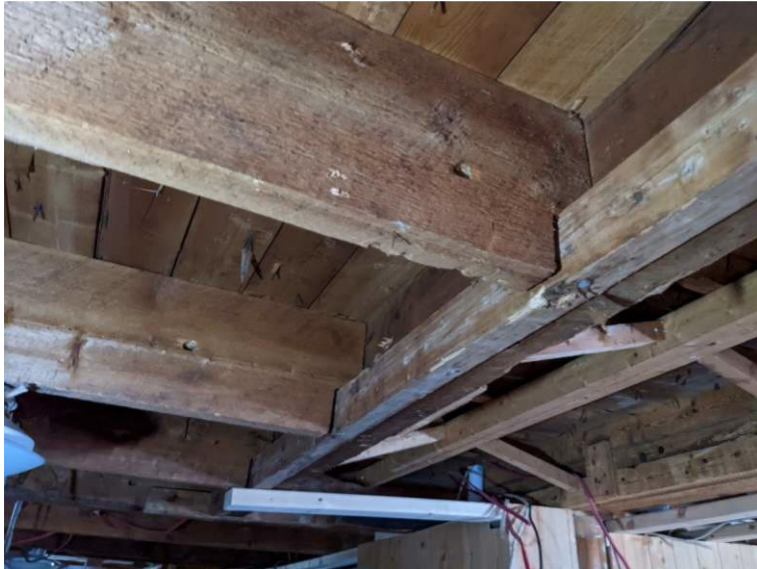
Fixation non-conforme de la lambourde
