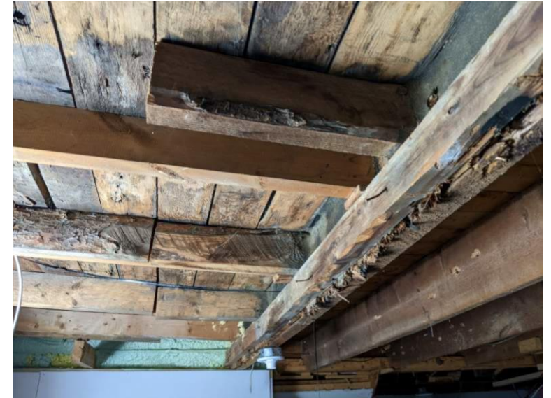
Structure de plancher non-conforme sous le vestibule
