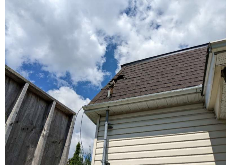
Trou dans le toit
