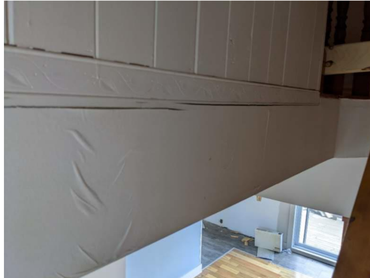
Fissuration à l'interface entre la solive et le platelage
