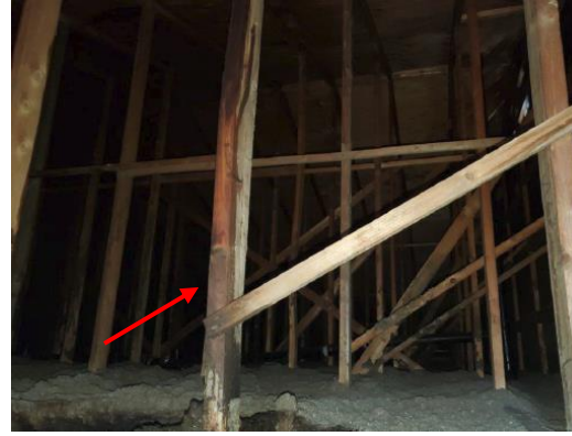
Trace d'écoulement d'eau sur les montants de bois
