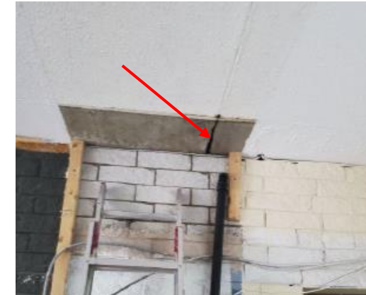
Dégradation d'un joint entre deux panneaux de béton
