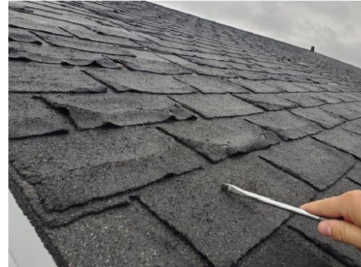
Dégradation avancée des bardeaux
