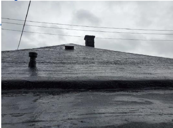
Toiture défectuelle en fin de vie utile
