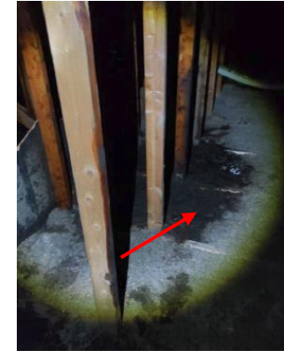
Trace d'accumulation d'eau dans le comble
