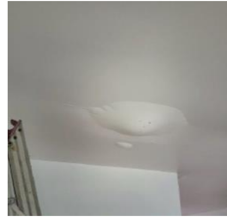
Accumulation d'eau dans le comble
