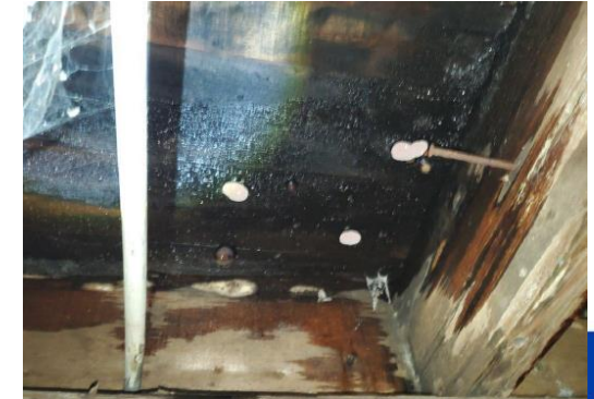
Moississures et champignons sur la structure de plancher
