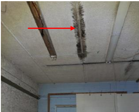
Trace d'eau et de moisissures au plafond
