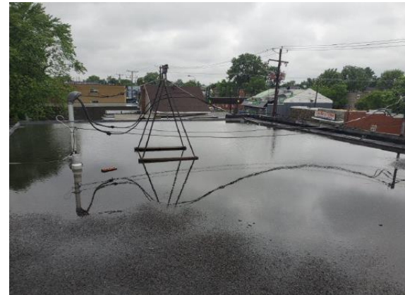
Accumulation d'eau sur la toiture
