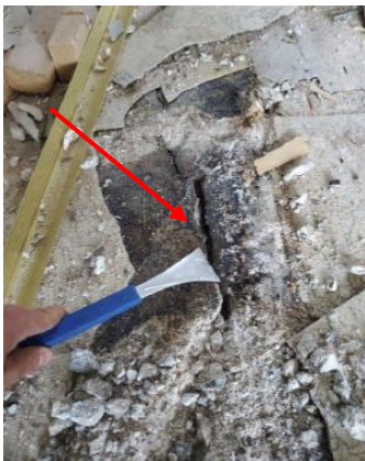
Fissure de la dalle de sol
