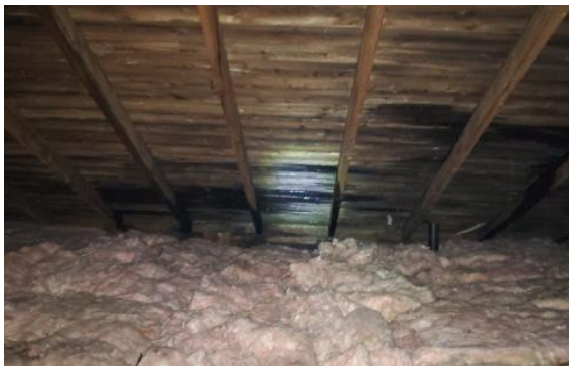
Toiture défectuelle en fin de vie utile
