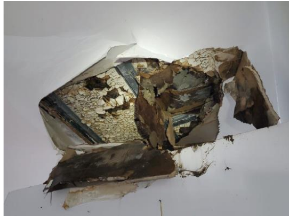
Pourriture du bois du comble
