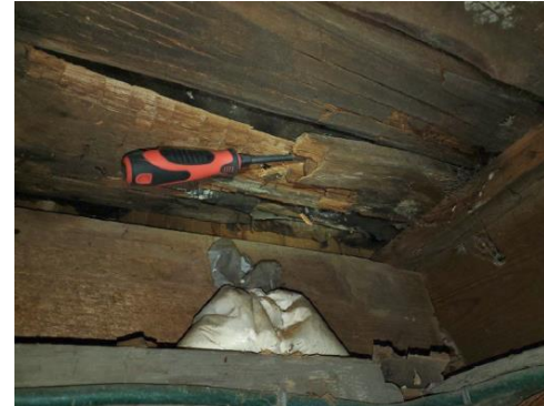
Pourriture à de multiples endroits sur la structure de plancher
