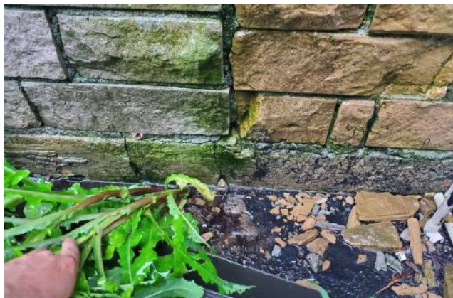
Fondation fissurée et éclat de béton
