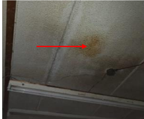
Trace d'eau et de moisissures au plafond
