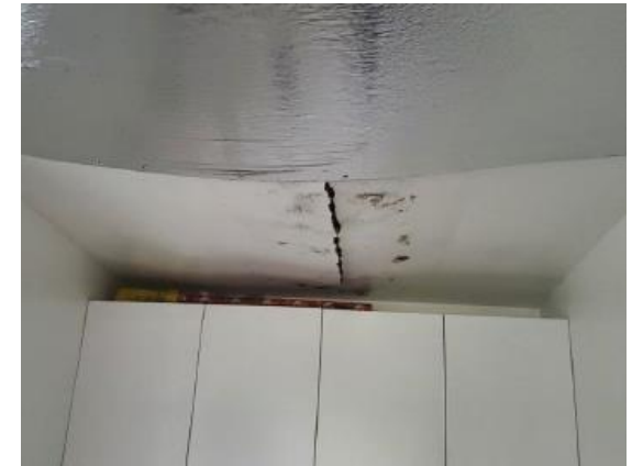
Infiltration d'eau et possiblement de la pourriture dans le bois
