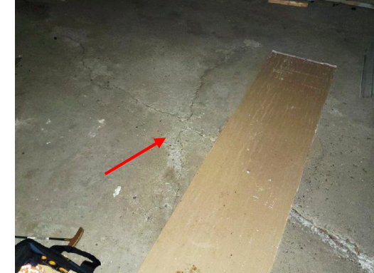
Fissure et gonflement de la dalle de béton
