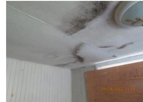
Traces de moisissures
