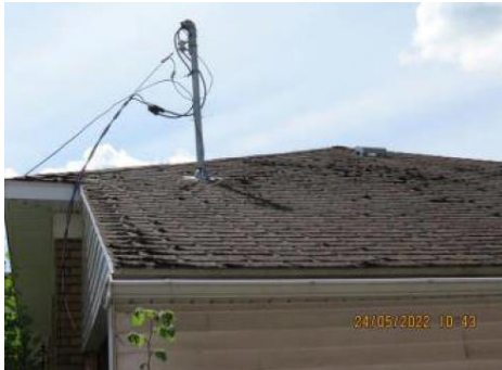
Bardeaux de toiture gondolés
