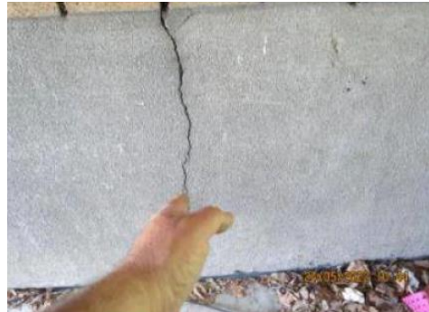
Fissures dans la fondation
