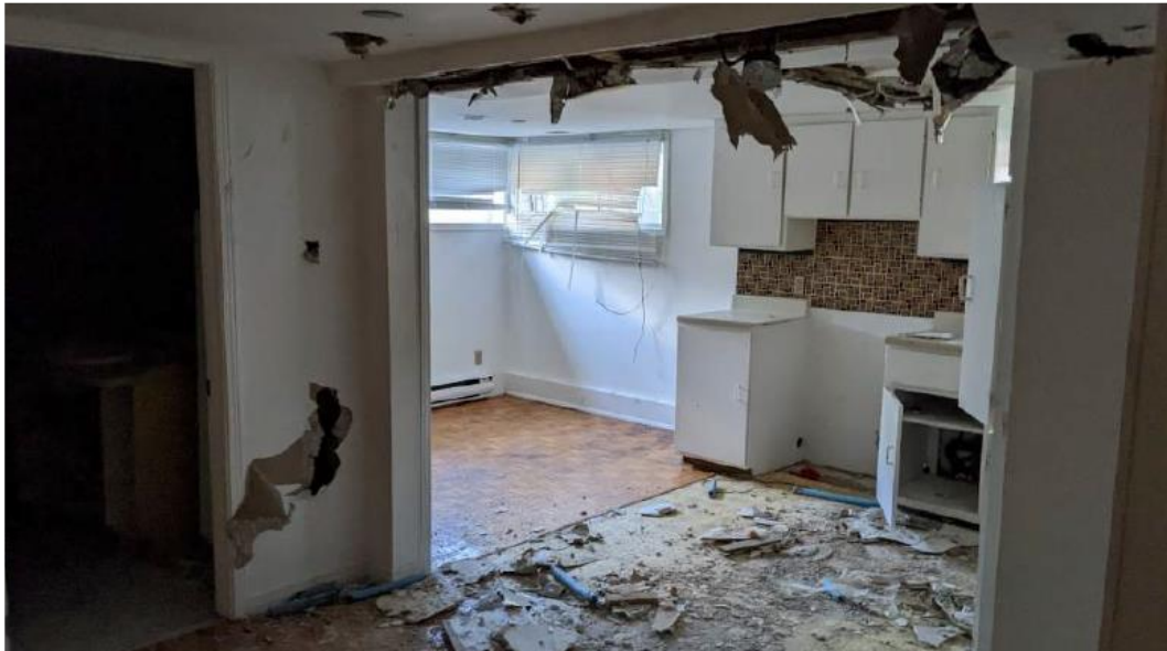
Fissure et déformation dans le plafond
