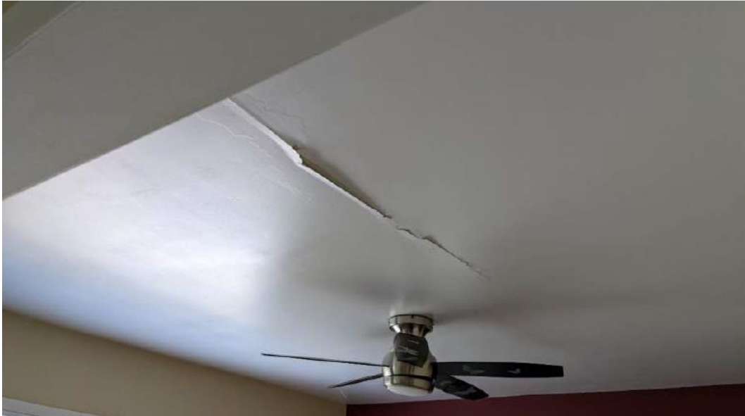
Fissure et déformation dans le plafond
