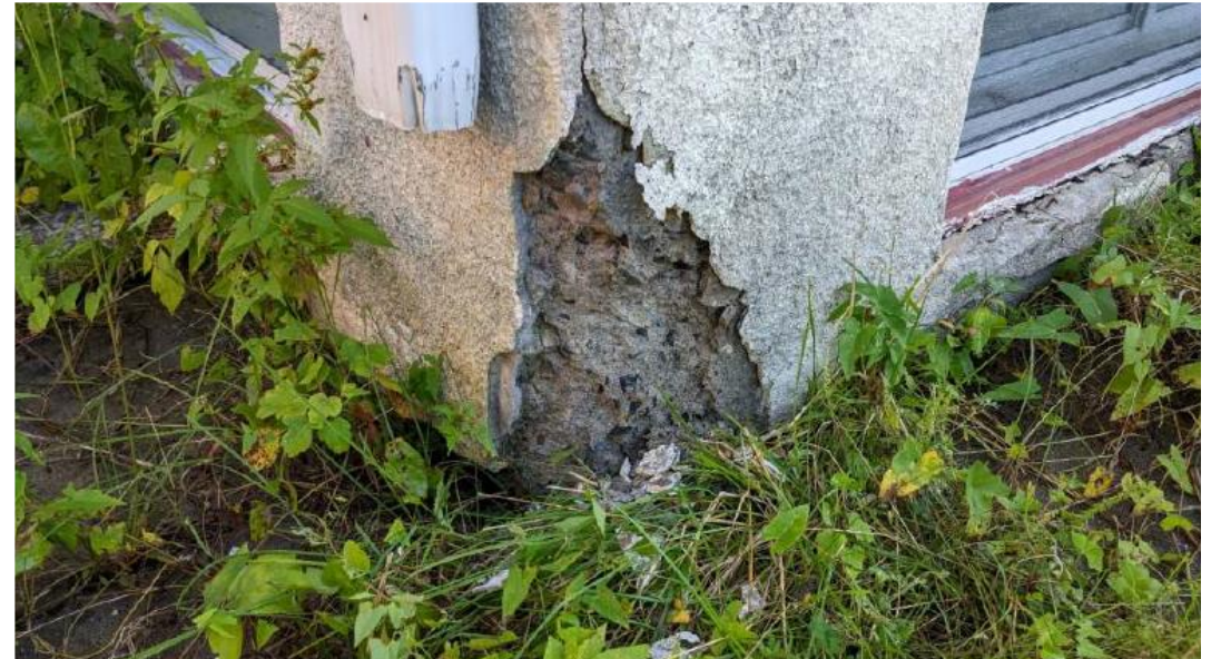
Présence d'effritement de la fondation
