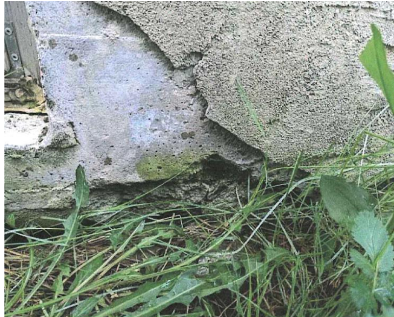
Béton et crépi endommagé
