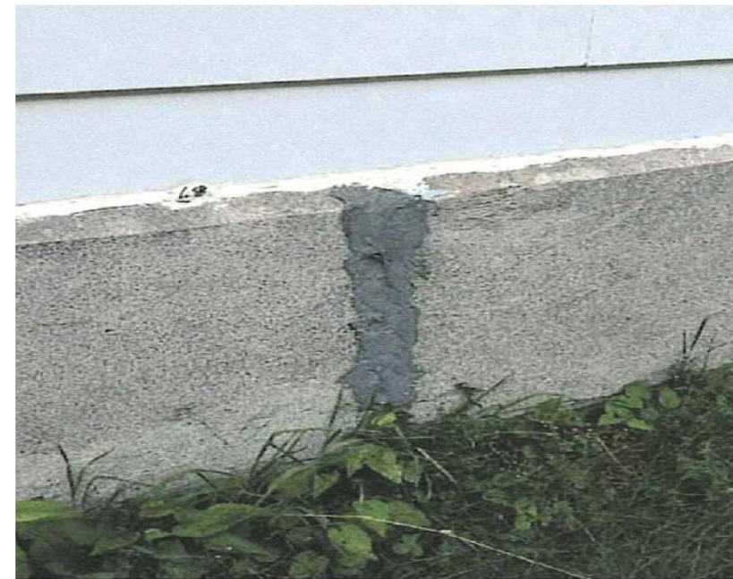
Présence d'une fissure
