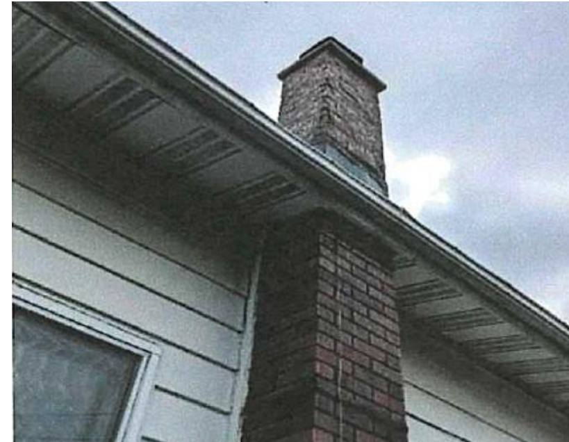
Maçonnerie de la cheminée endommagée
