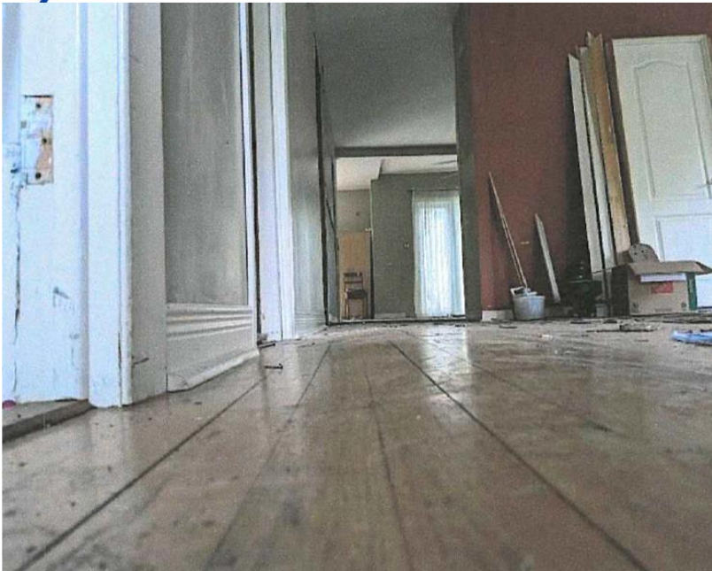
Désaxement entre les axes porteurs
