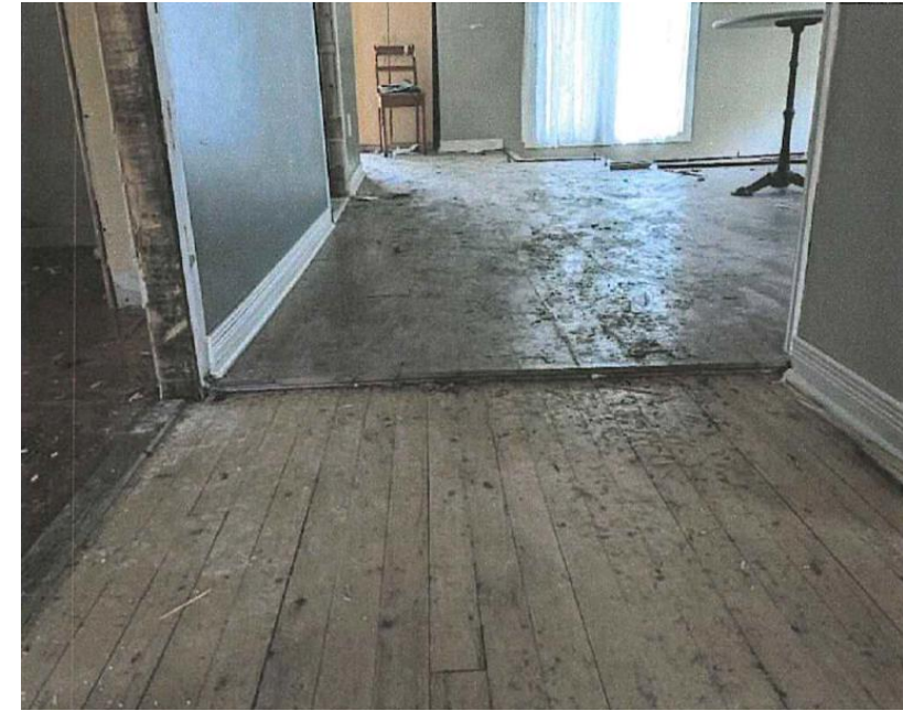
Affaissement important longitudinalement à l'axe central
