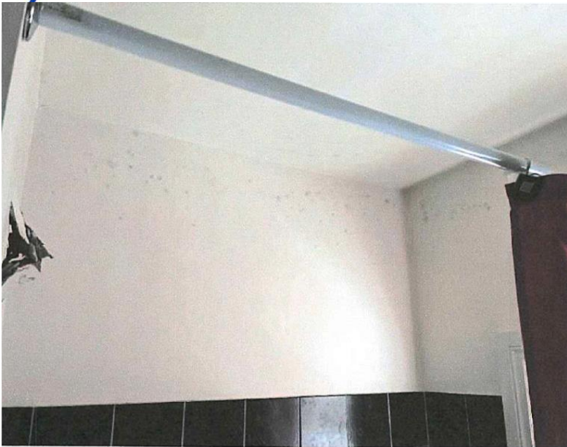
Traces de moisissure
