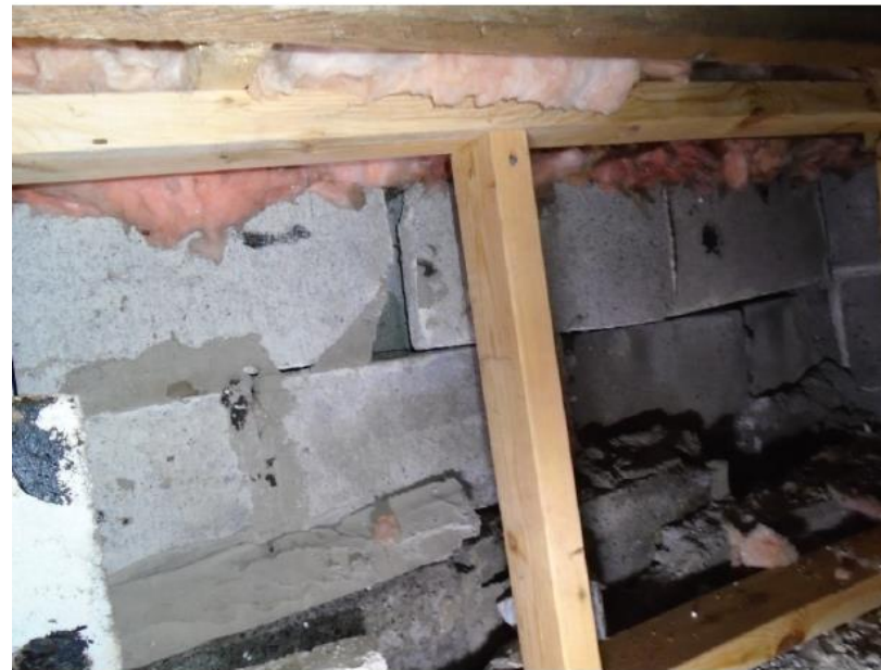
Bloc de bétons qui ont bougés
