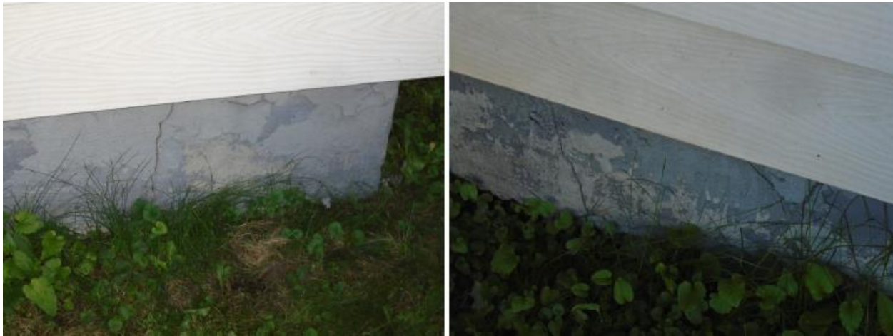
Fissures dans la fondation
