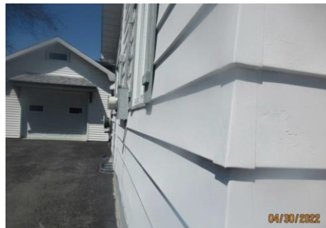
Courbure du mur extérieur
