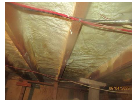
Poutres très humides près des fondations
