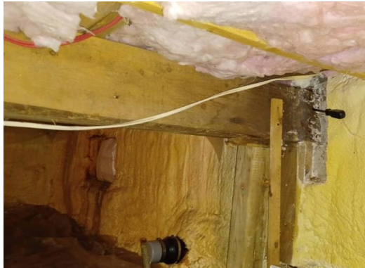
Poutre du RDC très humide
