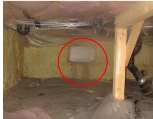
Infiltration d'eau dans le vide sanitaire
