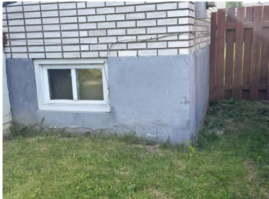
Zone d'accumulation d'eau de pluie proche des fondations du garage.
