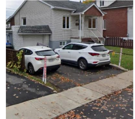
Mauvais état de l'asphalte du stationnement.
