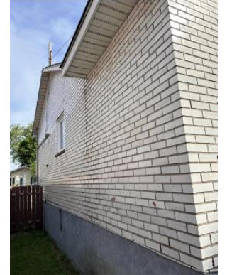
Courbure du mur extérieur côté droit.
