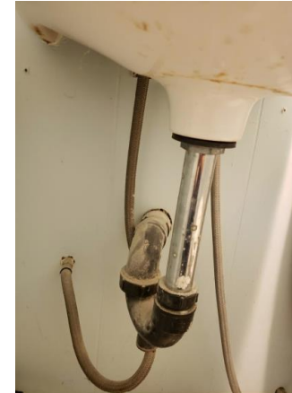
Absence d'évent dans le système de drainage.
