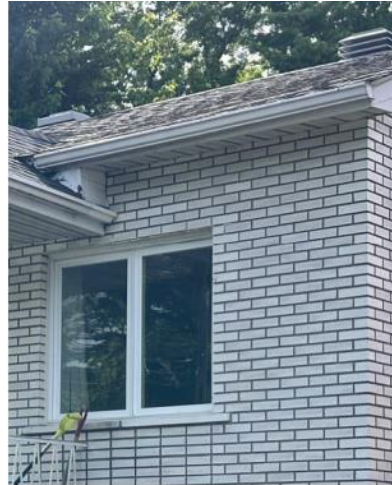
Soffites de prise d'air sont insuffisantes.
