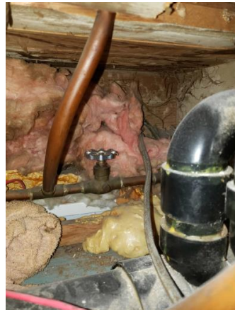
Valve d'entrée d'eau principale au sous-sol.
