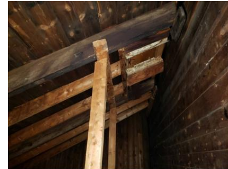
Mauvaise isolation de la toiture.
