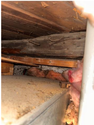
Structure du plancher endommagée et affaiblie par l'humidité/pourriture.
