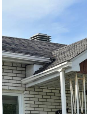
Mauvais état des bardeaux d'asphalte du toit côté avant.
