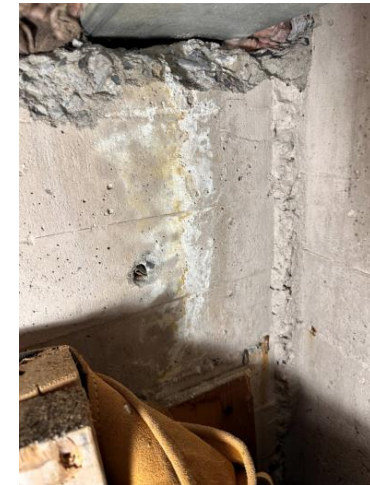
Murs de fondations sans isolation au sous-sol.
