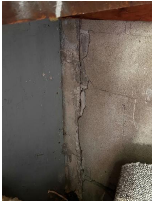
Mauvais état des fondations côté arrière droit.
