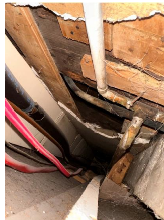
Conduits en cuivre mal supportés.
