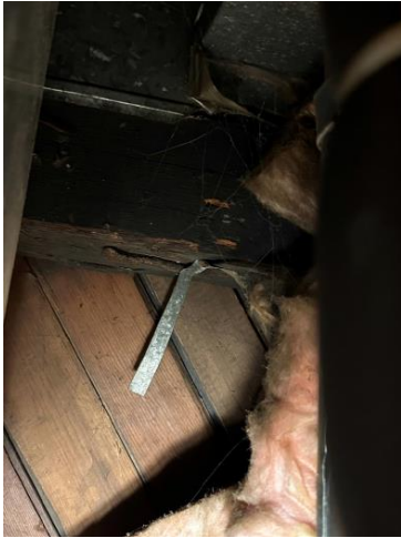
Indice de contamination fongique (moisissure) dans l'entretoit.
