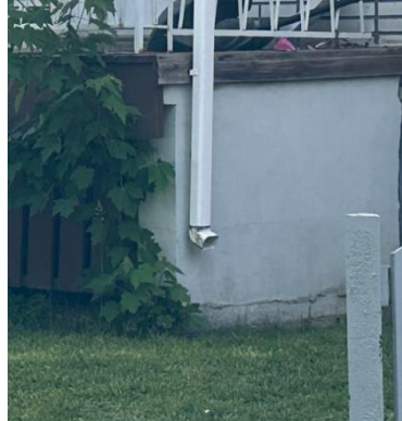
Gouttières trop proches des fondations.
