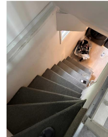
Escalier du sous-sol présente un danger aux occupants.
