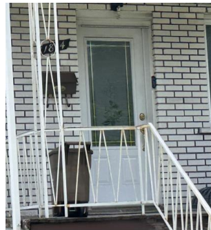
Mauvais état de la porte d'entrée principale côté avant.
