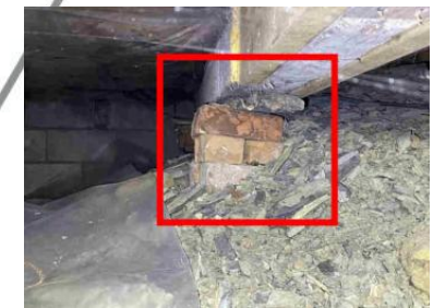
Poutre instable et solidifiée de façon artisanale
