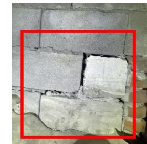
Mortier absent et affaissement du mur
