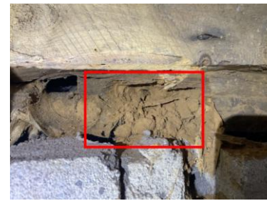
Effritement de la structure
