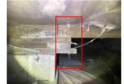
Poutre instable et solidifiée de façon artisanale
