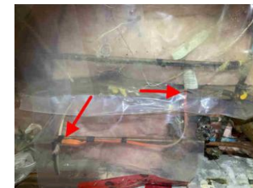
Branchement électrique artisanal
