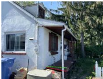
Affaissement de la terrasse
