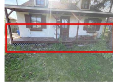
Absence de garde-corps
