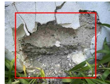
Fissure et effritement de la fondation
