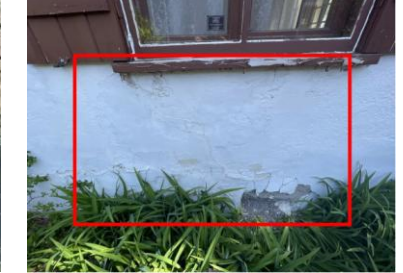
Bombement du crépi ou des briques sous-jacentes
