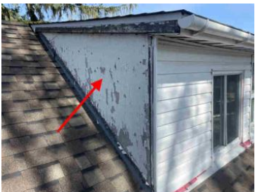
Absence de revêtement
