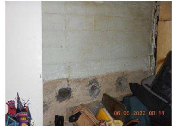
Infiltration dans cette zone, à l'arrière de la maison (source: Alain Boucher)
