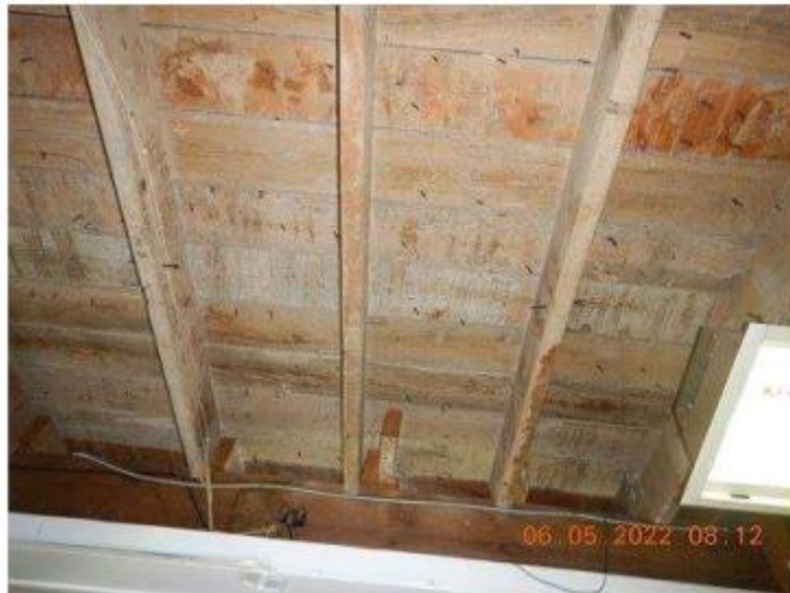
Usure avancée de la structure de plancher (source: Alain Boucher)
