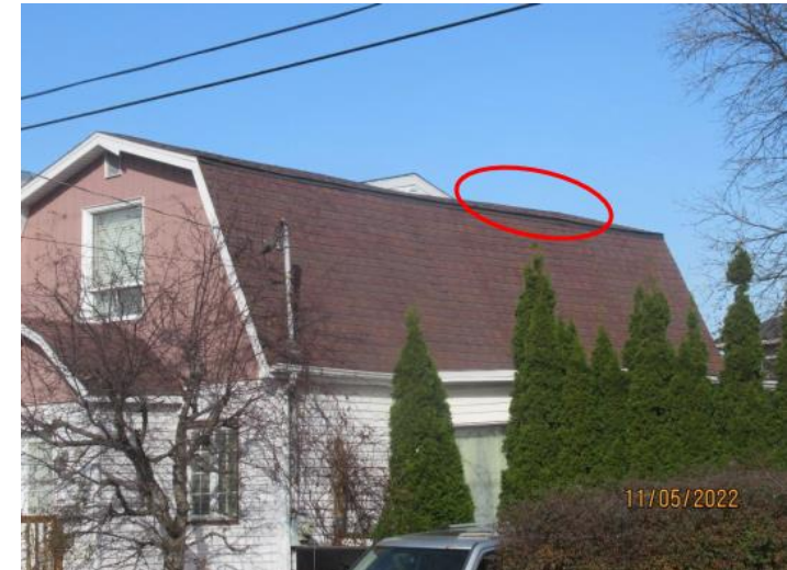
Signes de fléchissement de la structure du toit
