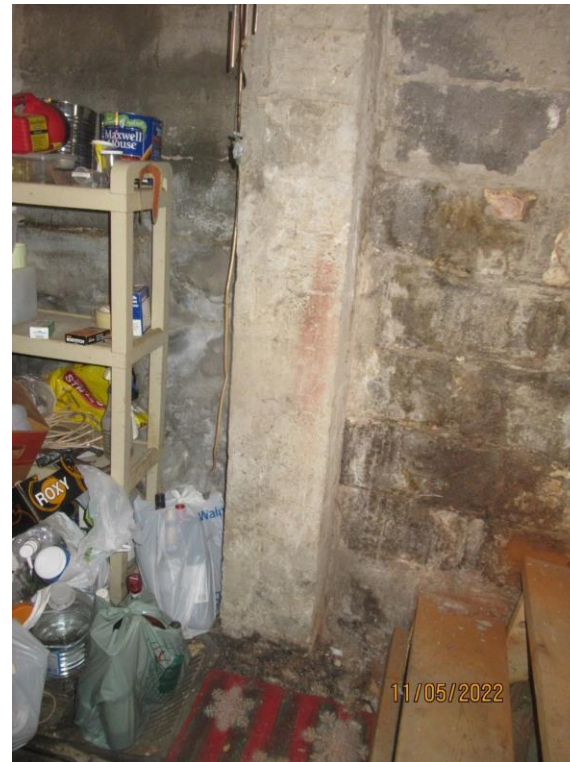
Infiltration d'eau active au vide sanitaire
