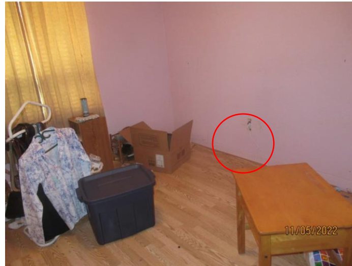
Prise électrique endommagée
