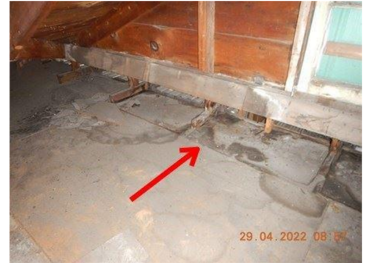
Signe d'infiltration d'eau dans le grenier
