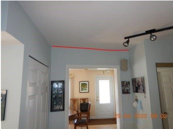
Déformation du toit
