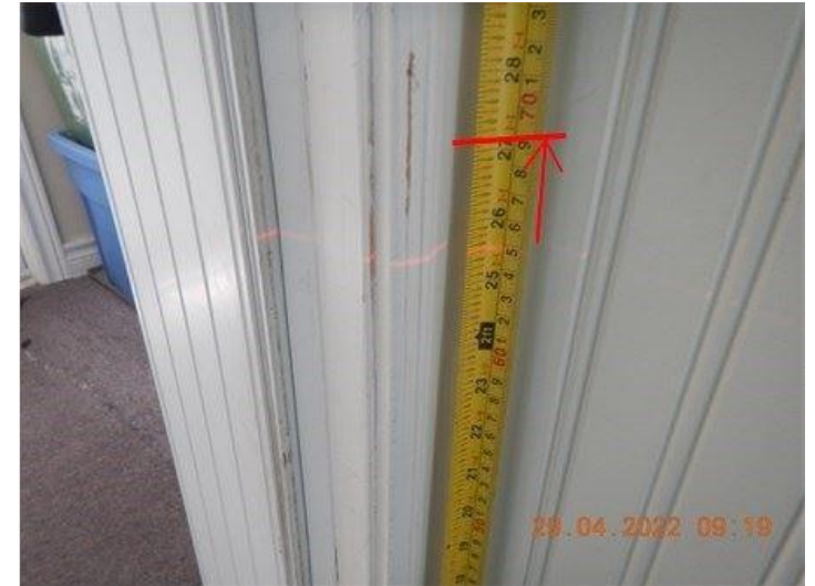
Dénivellation du plancher
