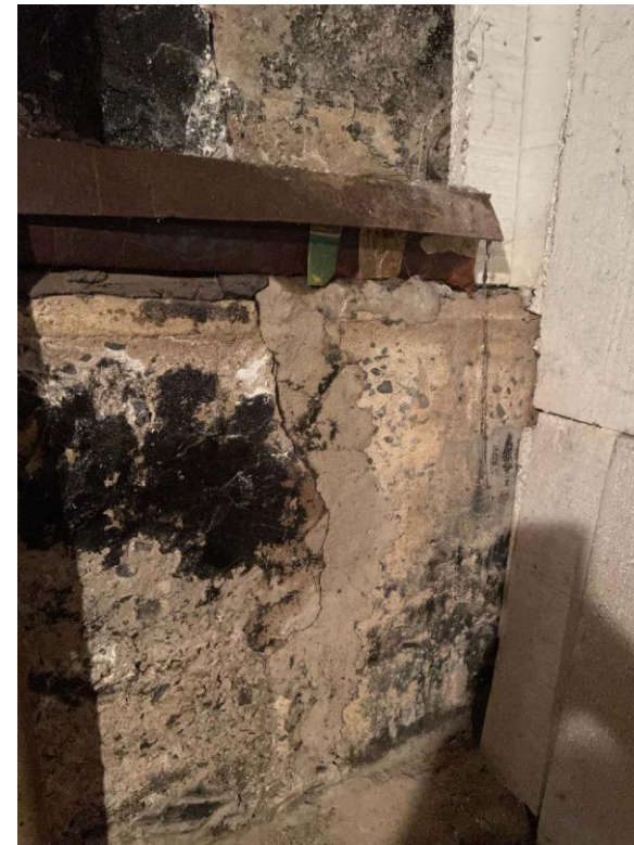
Fissure dans la fondation
