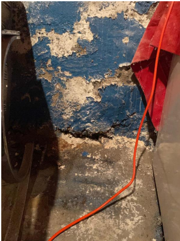
Présence d'efflorescence sur la fondation
