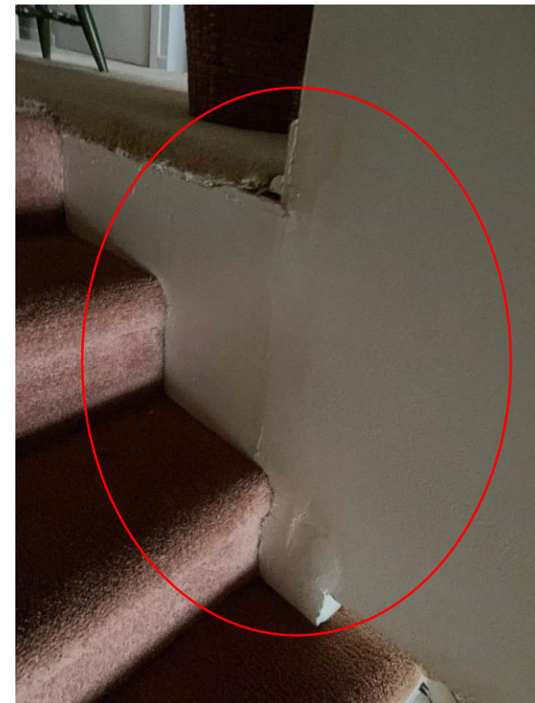
Déformation dans le mur de l'escalier
