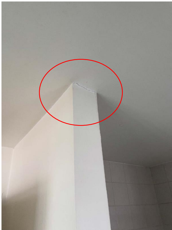
Fissure dans la jonction du mur et du plafond
