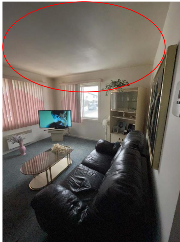
Déformation dans le plancher du second étage
