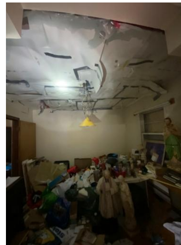
Section de revêtement de plafond détruit – arrière droit
