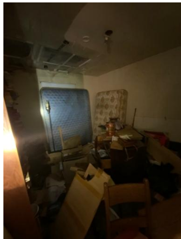
Section de revêtement de plafond détruit – avant gauche
