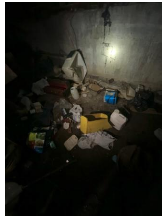
Semelle du mur de fondation arrière non remblayée
