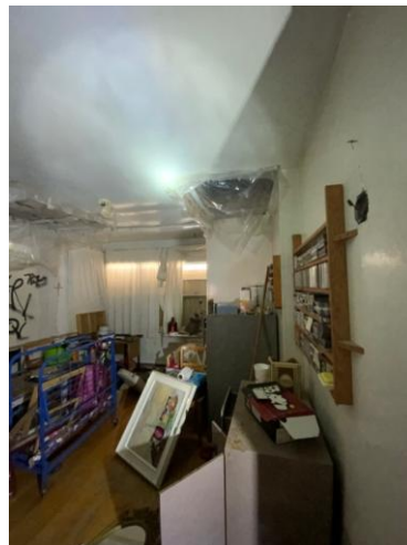
Section de revêtement de plafond détruit – avant droit
