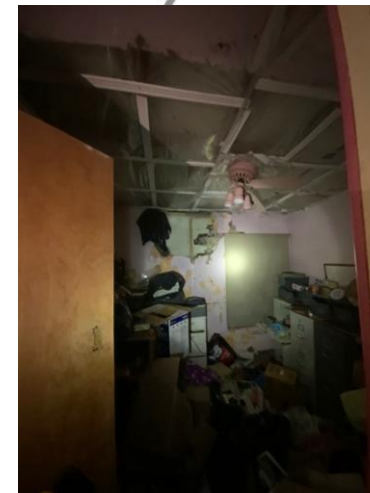
Section de revêtement de plafond et de mur extérieur détruits – arrière gauche
